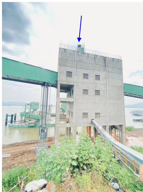
转运站除尘器
