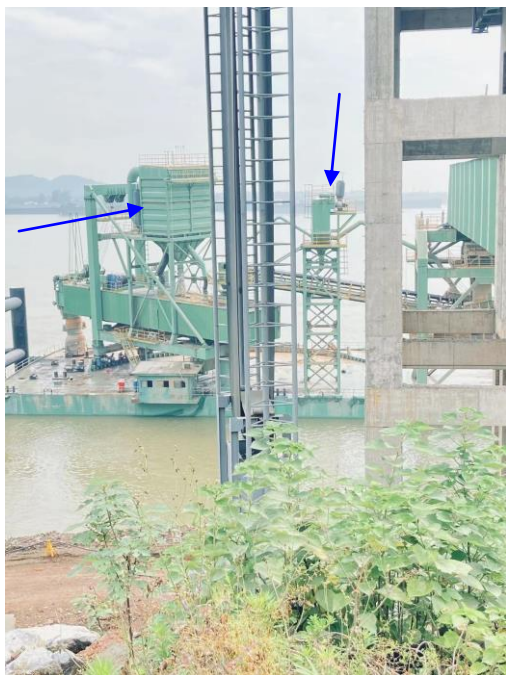
趸船处布袋除尘器
