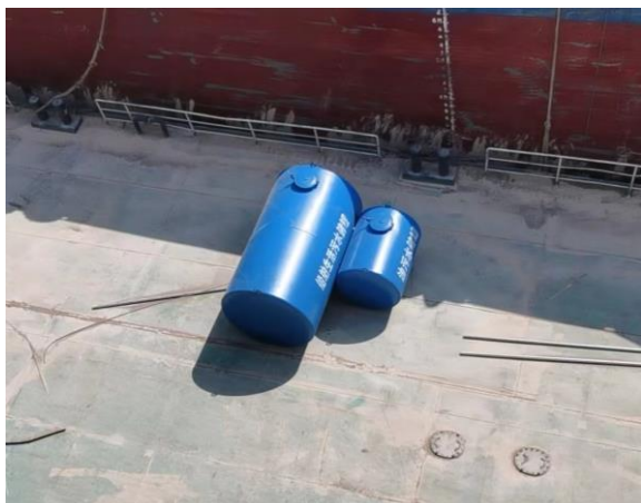
到港生活污水与油污水收集措施
