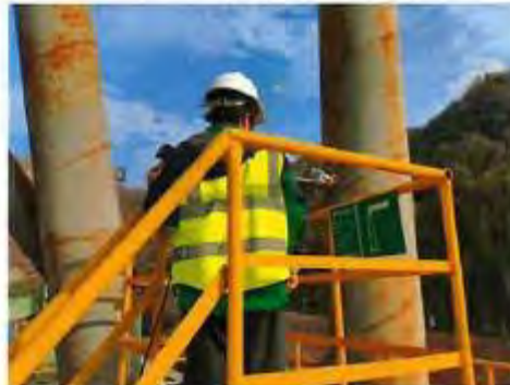
DDA015 廊道输送废气排放口
