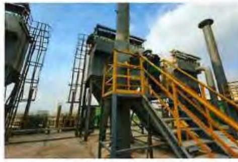
CDA034 搅拌楼进料输送废气排放口
