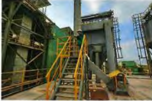
CDA033 搅拌楼进料输送废气排放口
