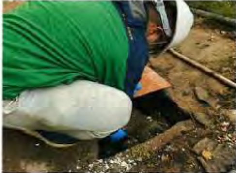
A 厂区、B 厂区一体化污水处理设施出口★FS1
