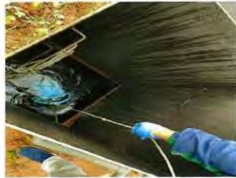
C 厂区一体化污水处理设施出口★FS2
