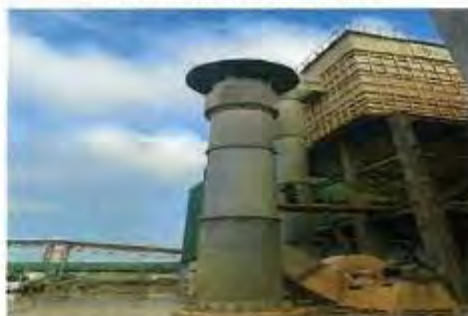
CDA023 制砂楼 1 破碎、筛分废气排放口
