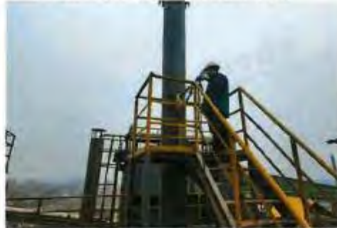
CDA036 搅拌楼进料输送废气排放口
