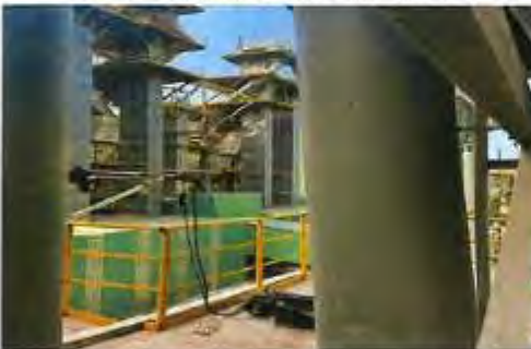
CDA028 搅拌楼进料输送废气排放口
