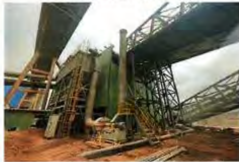
BDA007 整形破碎车间废气排放口
