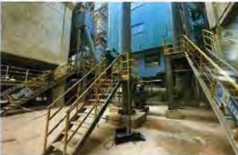
CDA031 搅拌楼进料输送废气排放口
