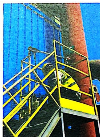
2#包装机排气筒
